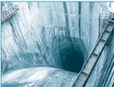
Водоводы Чиркейской ГЭС
